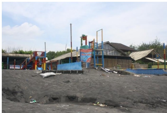
Gambar 12. Area wahana permainan dan tempat makan yang rusak terkena abrasi
