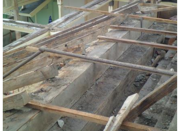
Gambar 6. Gandamaru yang tidak terpasang pada balok tumpangsari
